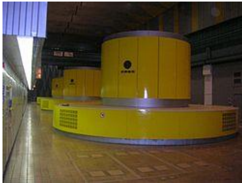
揚水発電所 発電機室
